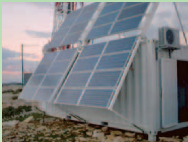
Αυτόνομο Φωτοβολταϊκό σύστημα τροφοδότησης απομακρυσμένου αναμεταδότη.
